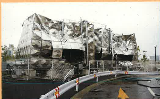
2011年 東日本大震災 SUSパネルタンクの被害
